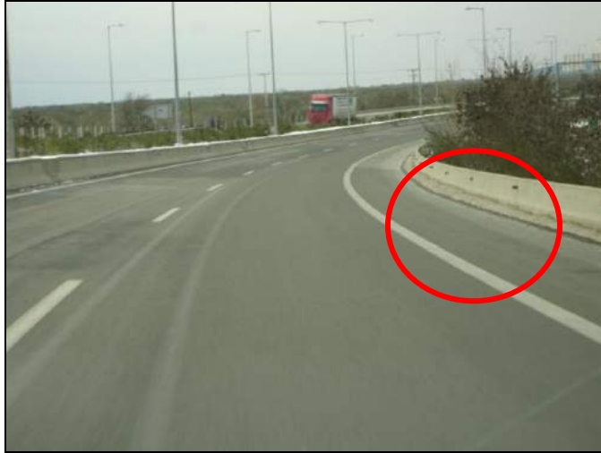
Εικόνα 28: Σε κόκκινο κύκλο βρίσκεται η Λωρίδα Εκτάκτου Ανάγκης. Ποτέ δε σταθμεύουμε επάνω σε στροφή χωρίς ορατότητα. Είναι προτιμότερο να σύρουμε το όχημά μας για λίγα μέτρα, από το να γίνουμε η αιτία δημιουργίας ενός σοβαρού ατυχήματος.
