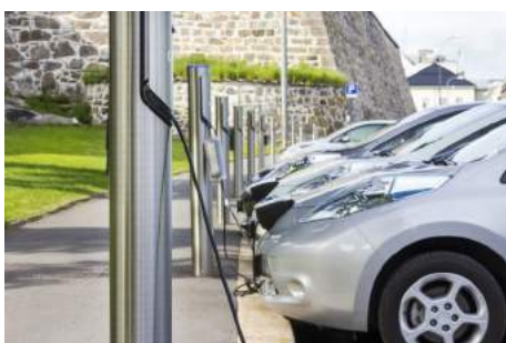
Εικόνα 5.55: Θέσεις φόρτισης ηλεκτρικών αυτοκινήτων κατά μήκος του πεζοδρομίου.
